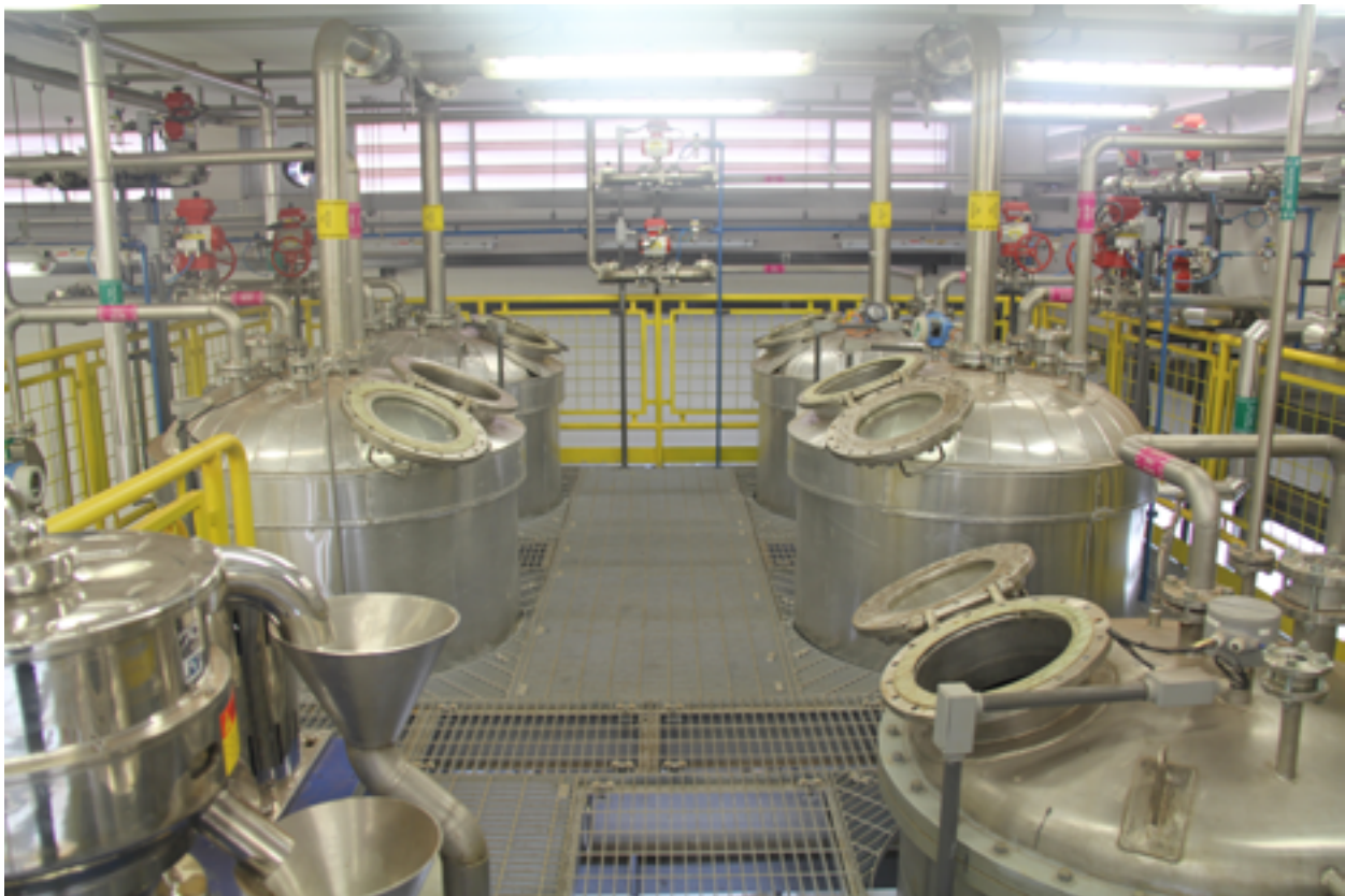
Estrutura conta com os setores de fermentação, destilaria, caldeira, tratamento de água, centro de operação e central de comando de motores
